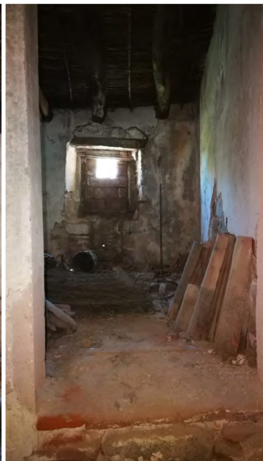
7: Àmbit planta superior, s'observa l'estat del dintell per la cara interior de la façana
