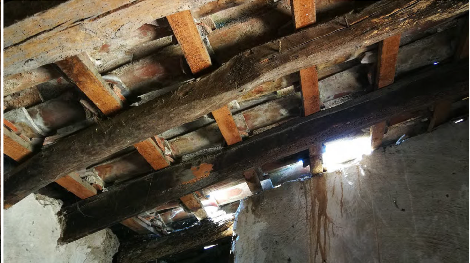
22: Detall estat de la coberta
