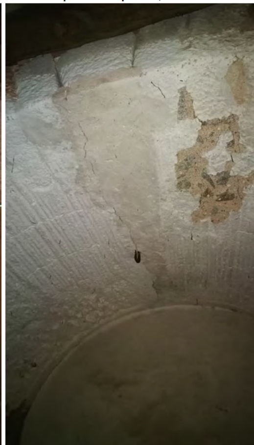
9: Fissura en clau de volta sobre tina
