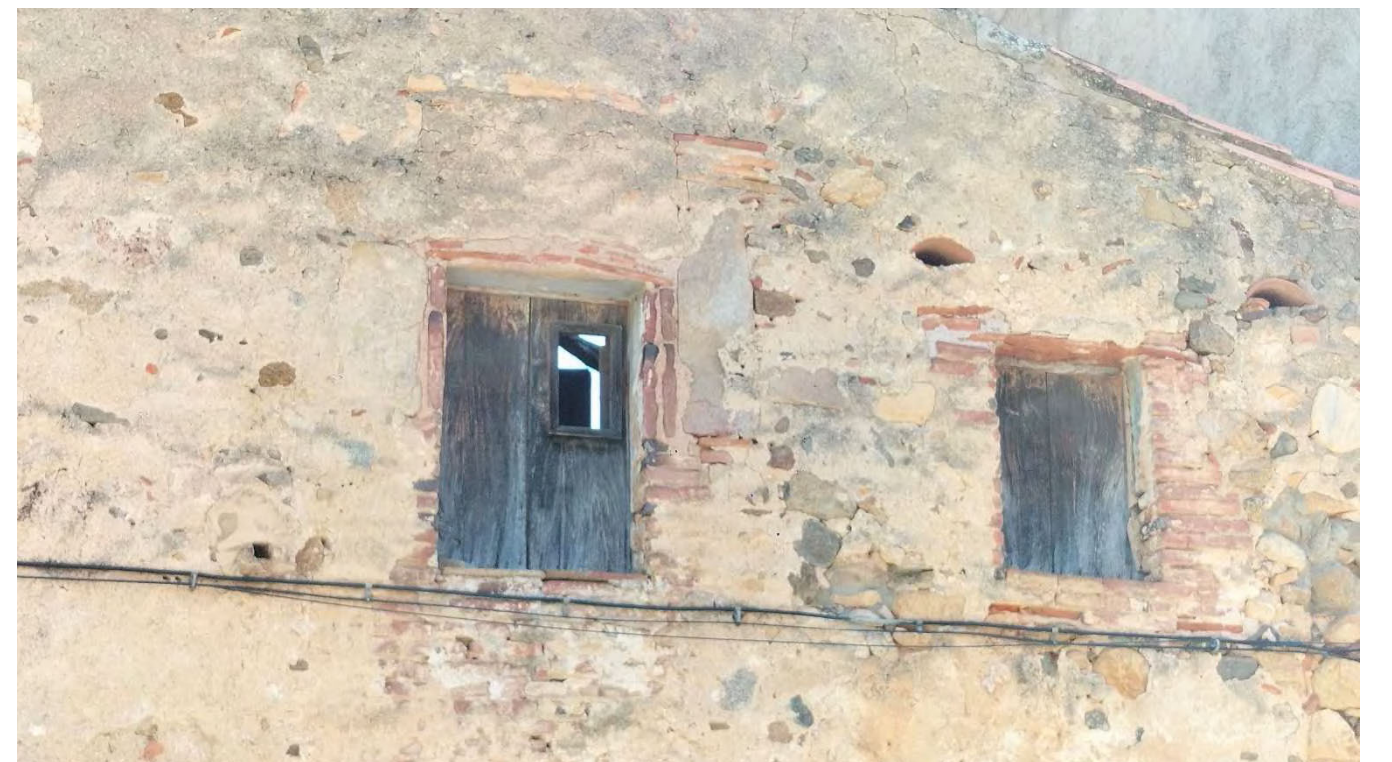
Detall finestres carrer Barceloneta núm. 14. Es pot veure part del cel a través que podria indicar que part de la coberta ha caigut
